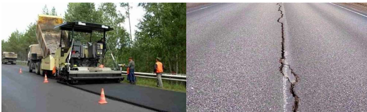
Рисунок 1 – Руйнування покриття в зоні поздовжнього стика
